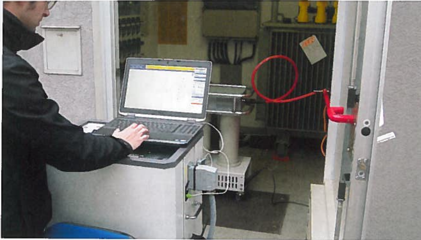
Bild 5. Durchführung einer TE-Diagnose
