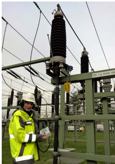
Bild 12: Vor Ort UHF Messung an installiertem UHF Sensor
