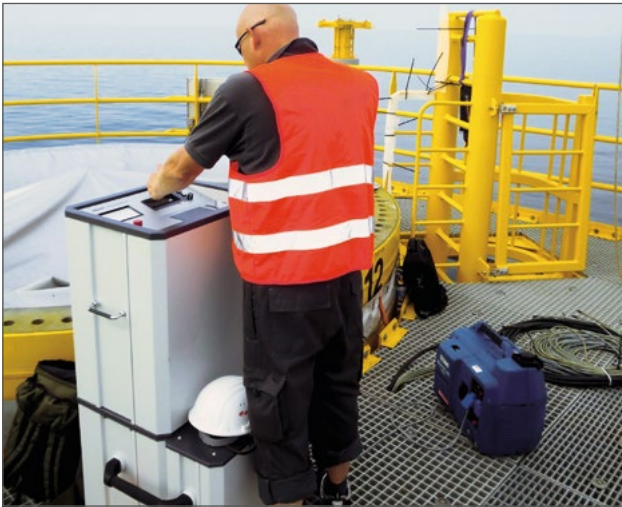
VLF CR-60 kV im Einsatz auf dem Windpark „Baltic 1“ in der Ostsee
