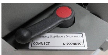
Fig. 39: Dispositivo de parada de emergencia.
