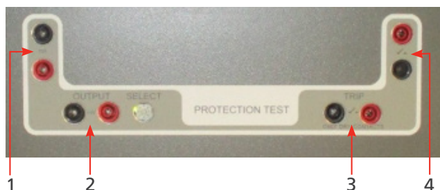
Fig. 41: Interfaz de relés de protección de CC
