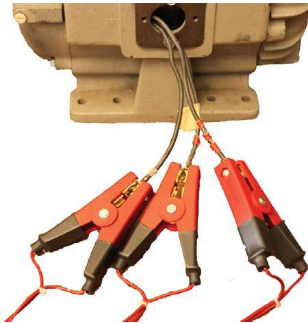
Rysunek 14. Podłącz przewody RLC do silnika.
