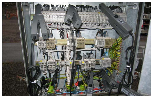
Figur 3 Kopplingskåp med strömtänger
