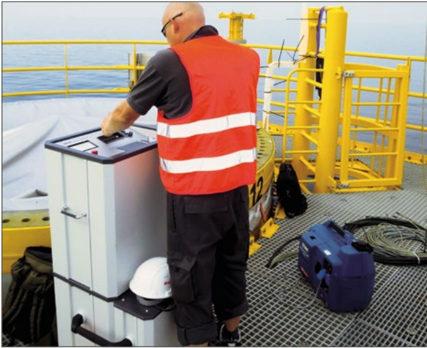
VLF CR-60 kV en operación en el parque eólico "Baltic 1" (mar Báltico).
