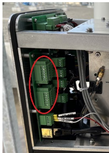
Figura9: Ubicación de relés de señal
