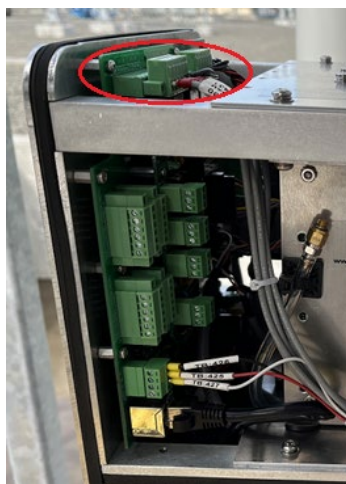
Figura11: Ubicación del relé de alimentación
